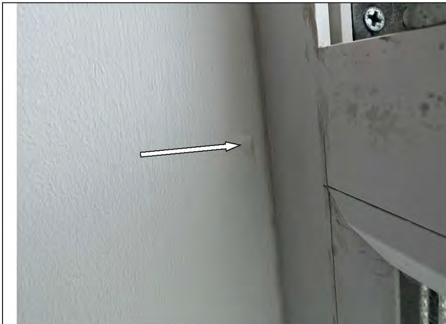
Фото №28. Механическое повреждение отколов оконного блока ПВХ в спальне.
