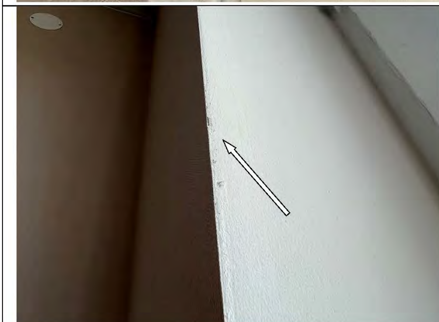
Фото №27. Отслоение покрасочного слоя от поверхности откосов оконного блока ПВХ в гостиной.
