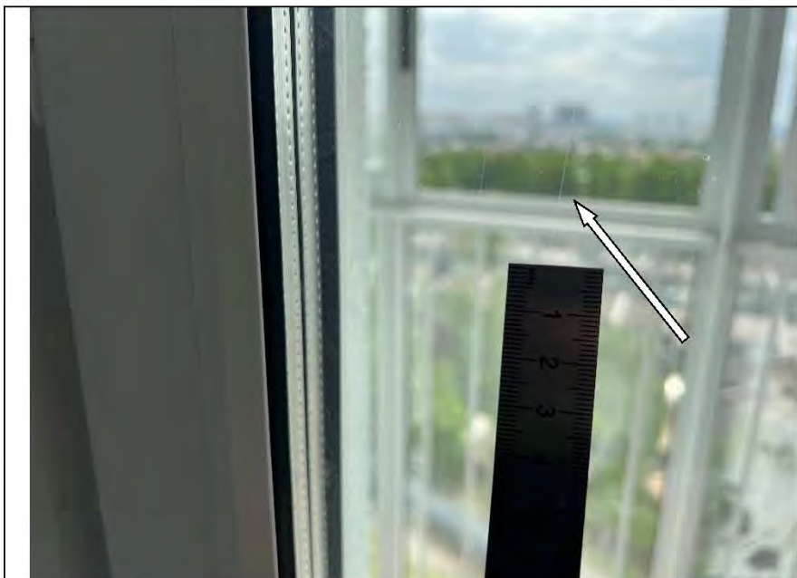
Фото №34. Царапина на стеклопакете оконного блока ПВХ в кухне.
