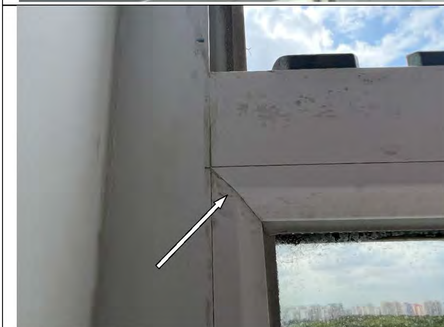
Фото №38. Зазоры в стыках профилей оконного блока ПВХ в спальне.
