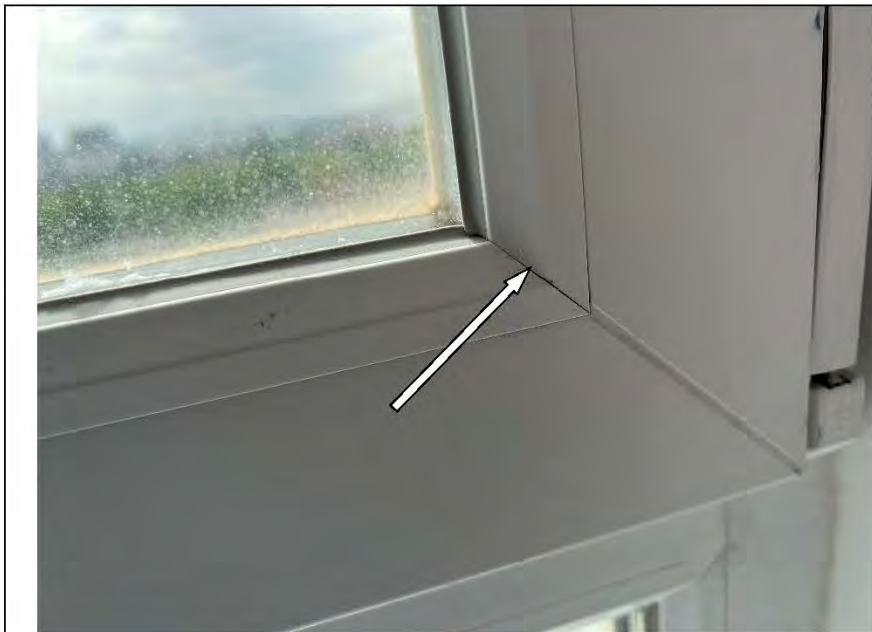
Фото №37. Зазоры в стыках профилей оконного блока ПВХ в спальне.
