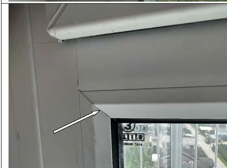
Фото №39. Зазоры в стыках профилей оконного блока ПВХ в кухне.
