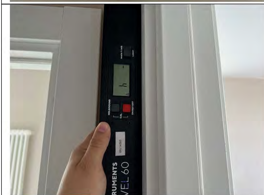
Фото №45. Отклонение наличников дверного блока в спальне равно 4 мм.
