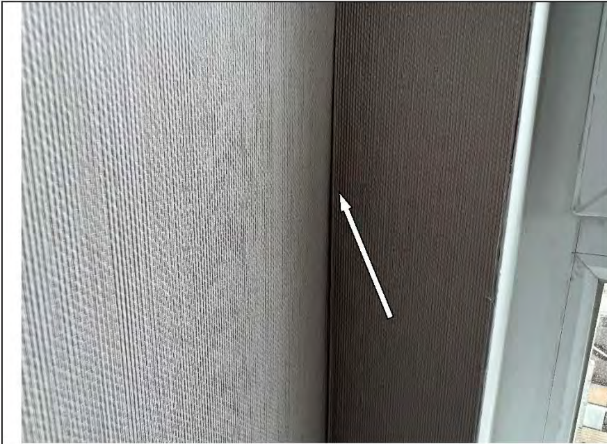
Фото №16. Читаемые обойные стыки в спальне.
