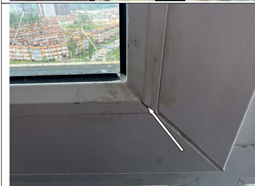
Фото №35. Зазоры в стыках профилей оконного блока ПВХ в гостиной.
