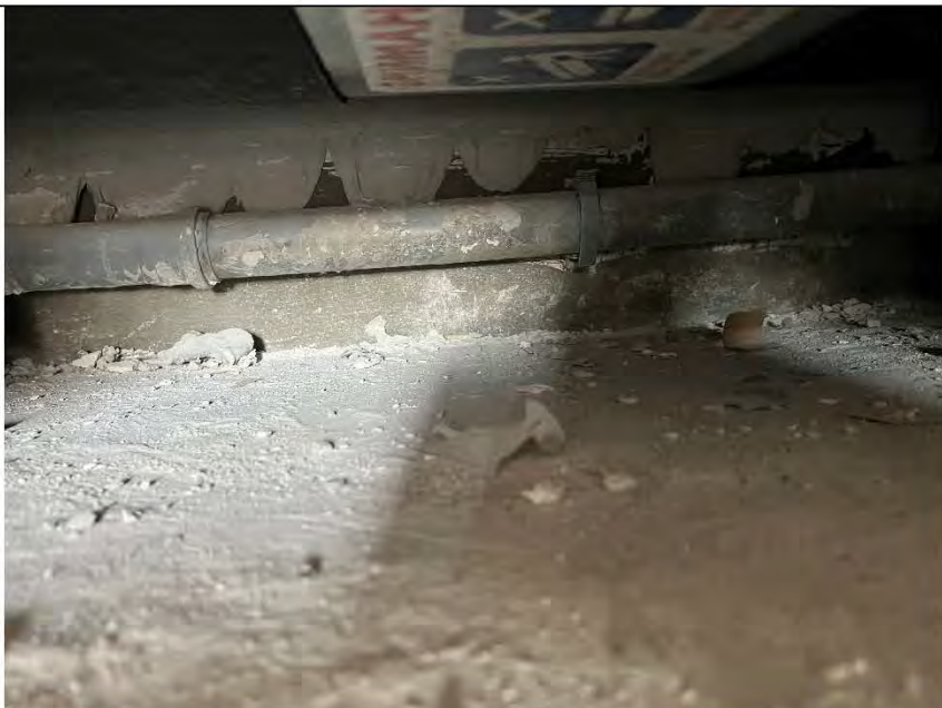
Фото №19. Отсутствует настенная керамическая плитка за ванной.
