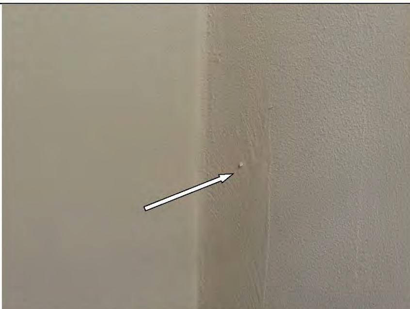
Фото №20. Подтеки краски на стенах в ванной комнате.
