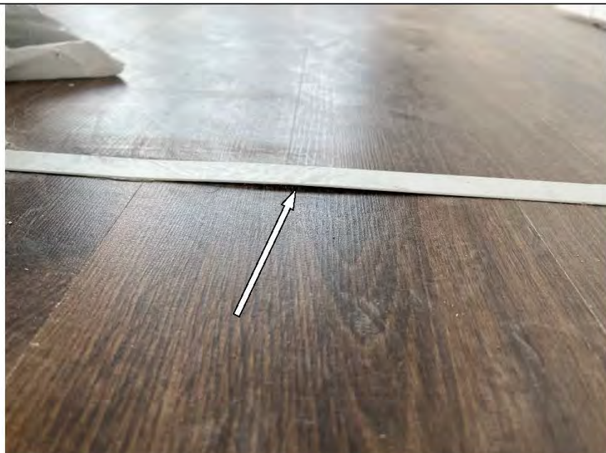
Фото №52. Щель в между металлическим порожком и ламинатом в кухне.
