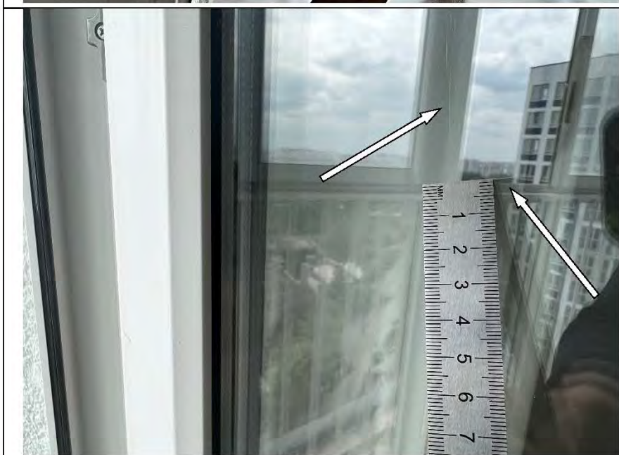
Фото №33. Царапина на стеклопакете оконного блока ПВХ в кухне.
