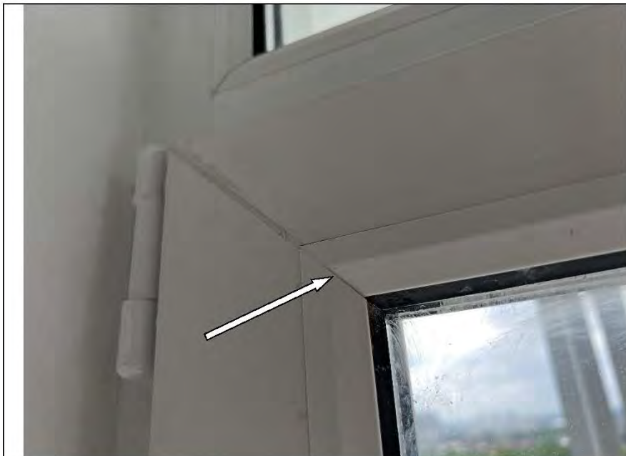
Фото №40. Зазоры в стыках профилей оконного блока ПВХ в кухне.
