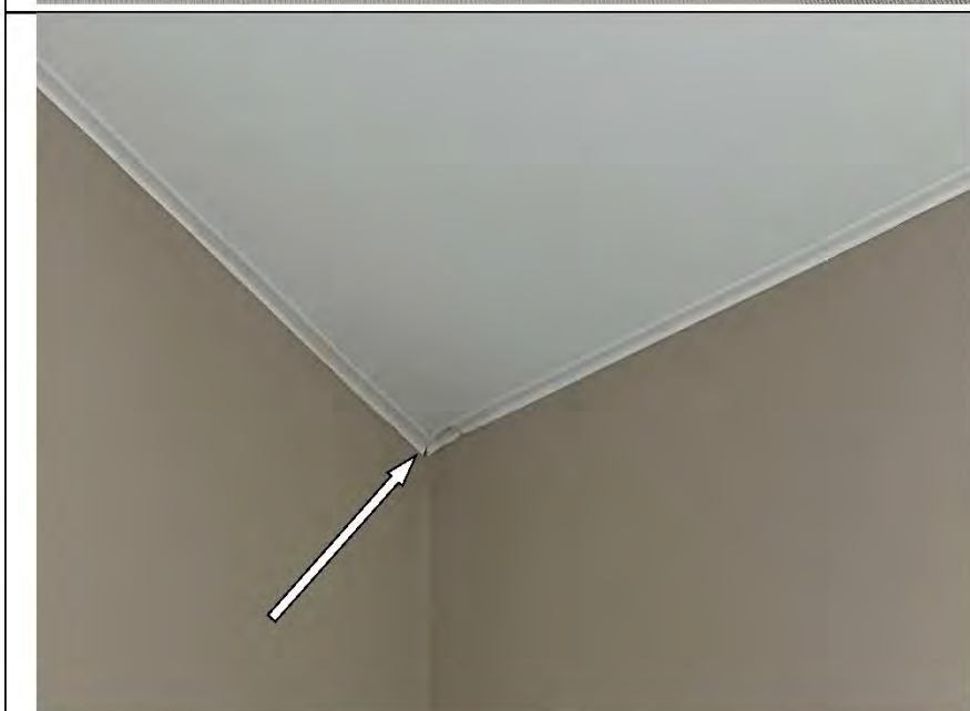
Фото №44. Дефект монтажа декоративного молдинга в ванной комнате.
