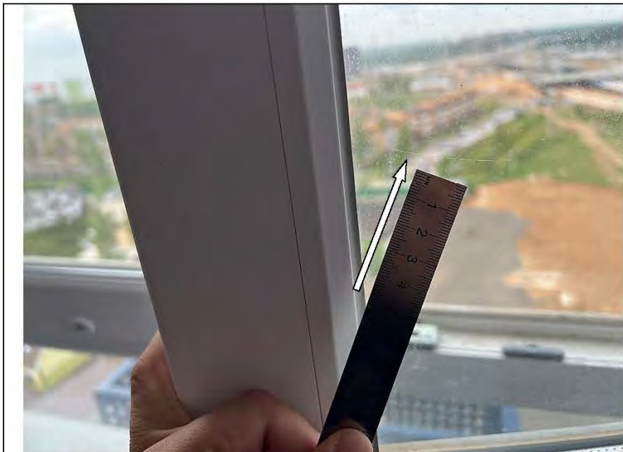
Фото №31. Царапина на стеклопакете оконного блока ПВХ в гостиной.
